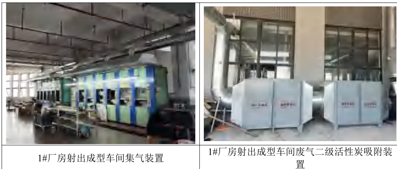
图 4-7 1#厂房 2F 射出成型车间废气处理设施图
