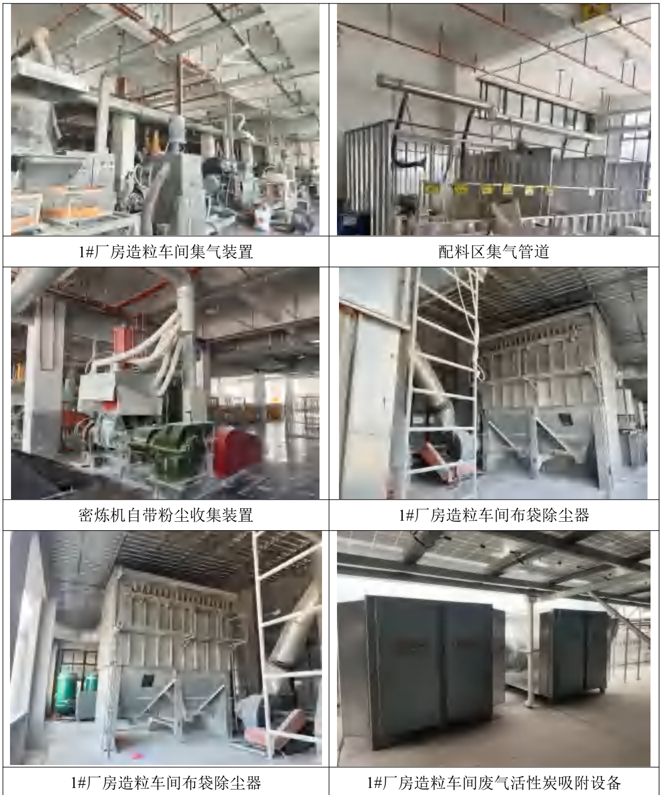
图 4-3 1#厂房造粒车间废气处理设施
